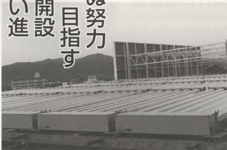
病院の屋上に設置された巨大な太陽熱ソーラー装置。院内の熱の大半をソーラーシステムで賄い、環境負荷軽減に寄与している
